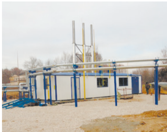
Новая газовая котельная в районе мебельной фабрики
